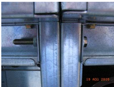
Figura24: Conexión 1 compartimiento cabeza de cables
