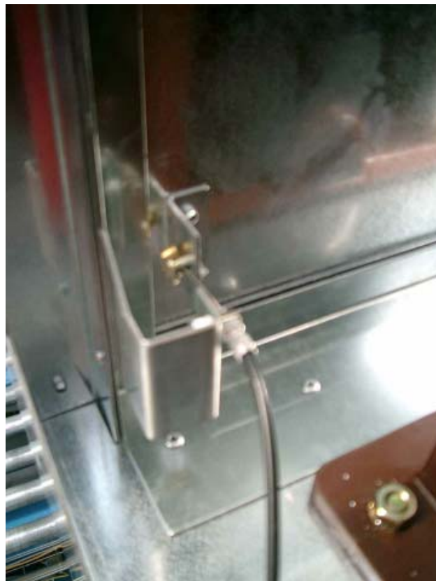
Foto 10: Kabelaansluiting in barenstelcompartment
