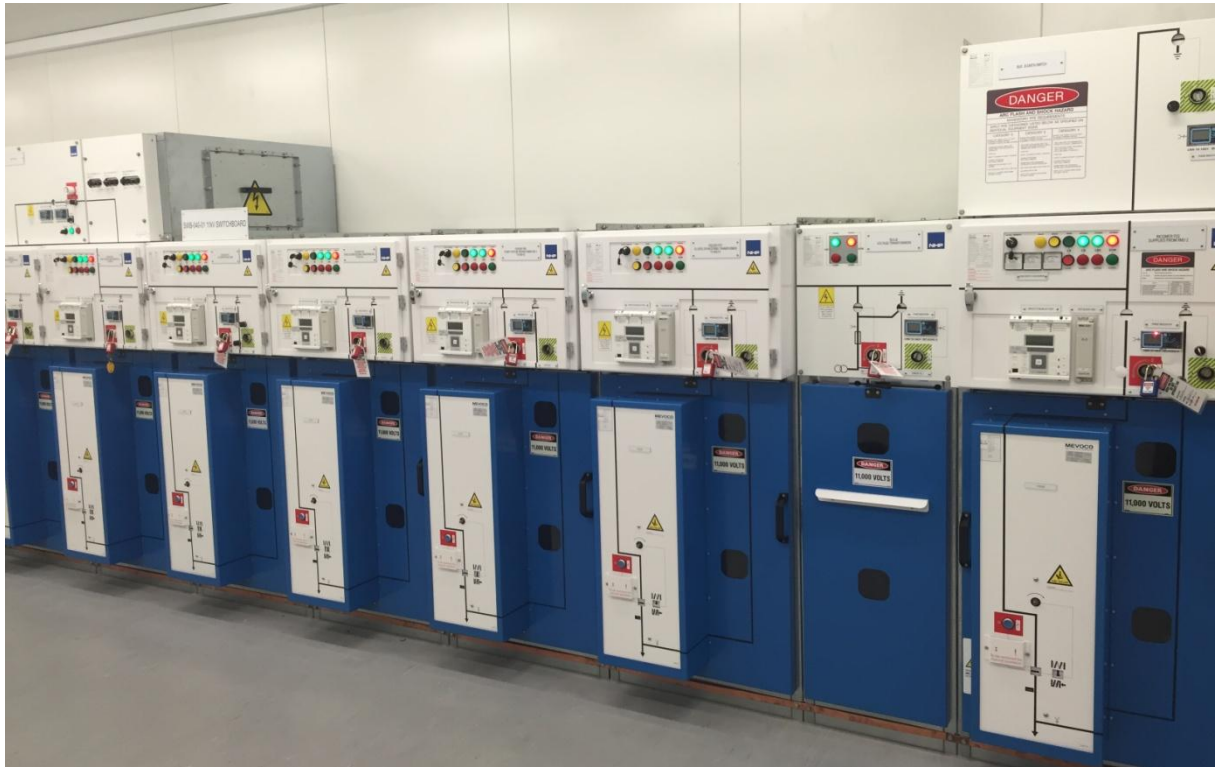
DF-2 switchgear project in Australië –QUU Oxley Creek – oktober 2016 © SGC
